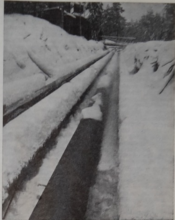
Lämpö etenee kuuman veden muodossa Tapiolan valtapatukistossa. Kysymys on historiallisesta hetkestä — 30.11.56 klo 10.05 — jolloin tässä vielä vanhasta lämpökeskuksesta tuleva lämpö on saavuttamassa uuden lämpövoimalaitosrakennuksen. Kuvasta näkyy selvästi, kuinka lumi pakenee lämmön tieltä. Kuvantottoa seuraavana päivänä saivat putket eristyksen ja nyt ne ovat jo varmasti maan alla piilossa, joten samanlaiseen täyrysumaan ei rkm. Leivon kameralle olisi tällä hetkellä mahdollisuuksia.
